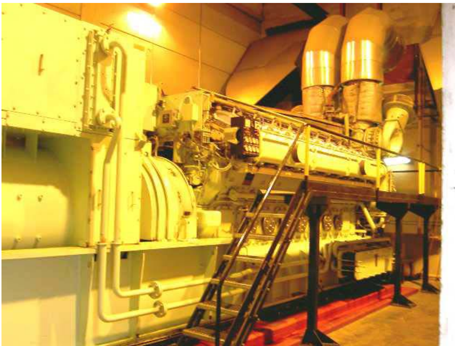
Figura 8: Motor nº 4 de la planta de cogeneración antigua.
