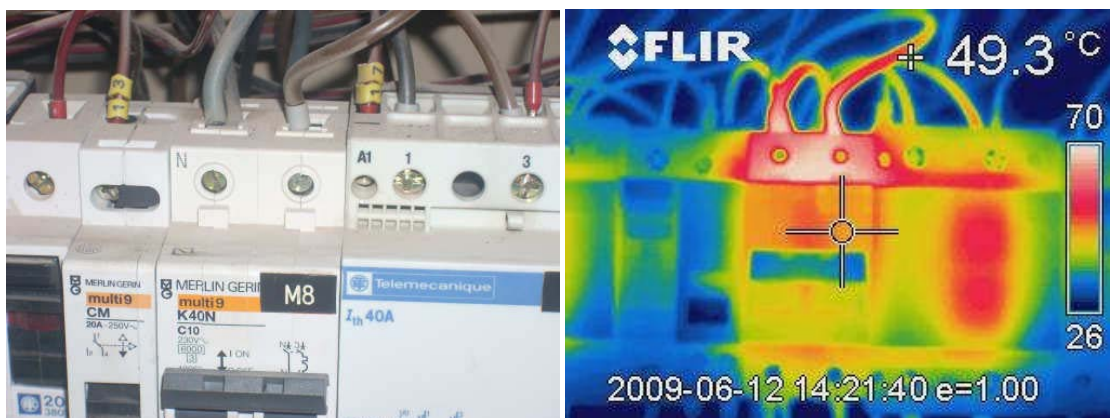
Figura 14: Ejemplo de termografía en instalación de alumbrado.
