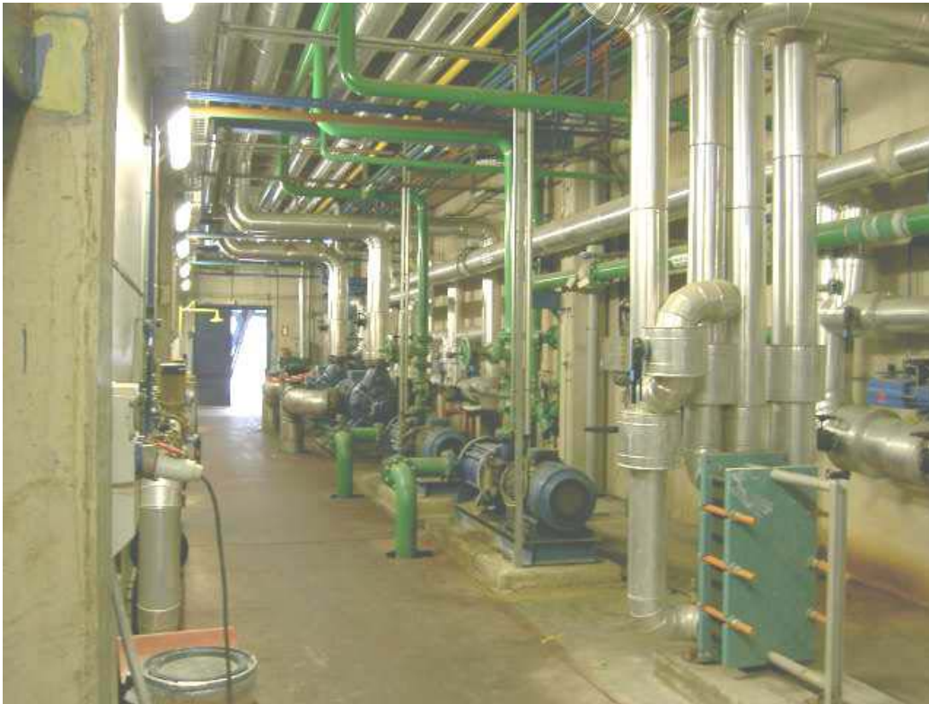
Figura 11: Sala de auxiliares de planta antigua. En primer plano, intercambiador de agua; en el centro, bombas de BT (tuberías verdes); al fondo, bombas de AT (tuberías calorifugadas).
